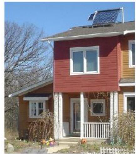
Afb.30.2: Een module voor warm water op zonne-energie levert warm water voor een gezin in Michigan. De pomp van het systeem wordt aangedreven door de kleine PV-module aan de linkerkant.
